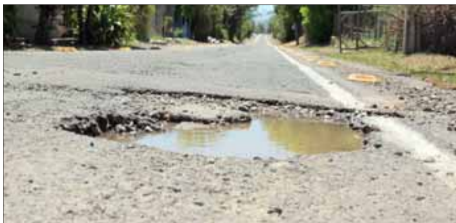
Vialidad está al debe en calle Brasil, donde este enorme agujero en el pavimento constituye un grave peligro de accidente.
