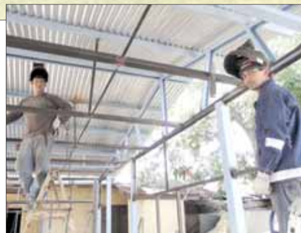
Mario Arévalo y René Villarreal, fueron sorprendidos por nuevas cámaras mientras laboraban en la soldadura de la nueva estructura.
