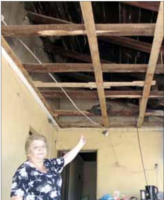
Muy deterioradas estaban las instalaciones en las que ellos se reunían, Viviana Meneses muestra a Diario El Trabajo la madera en mal estado, pero que pronto será sólo un recuerdo.
