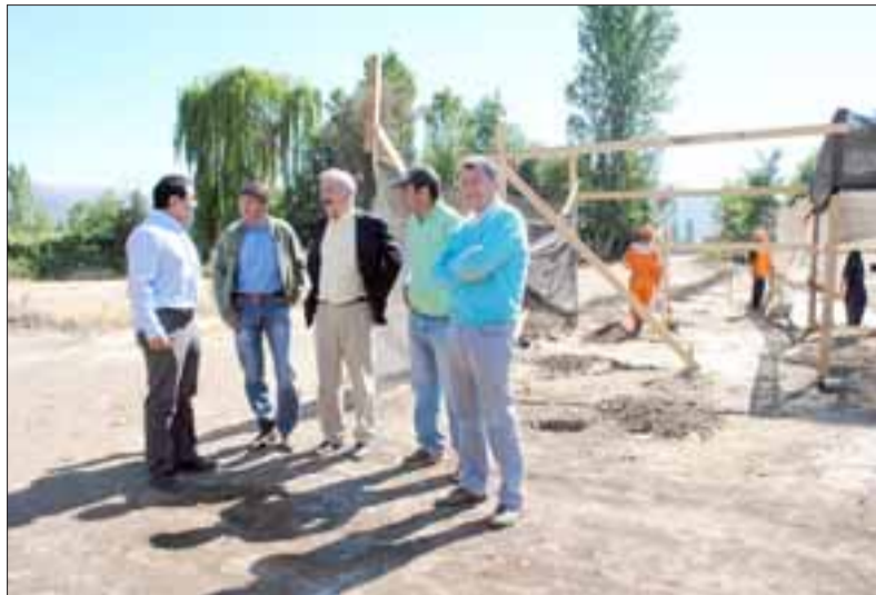
El Alcalde Patricio Freire junto al Core Eduardo León visitaron este martes el lugar para ver el avance de las obras.
