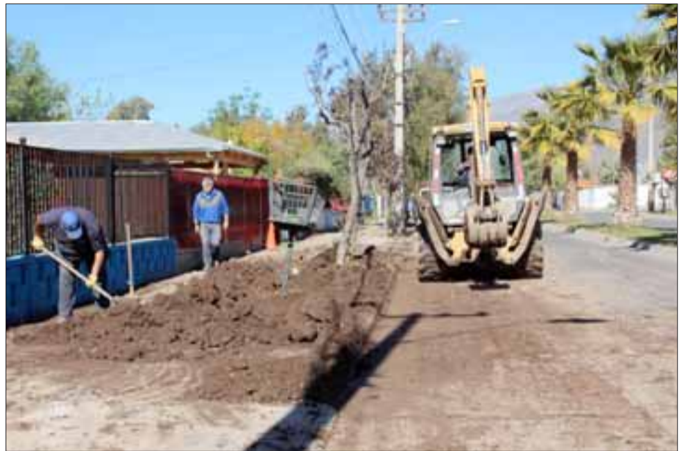
Ya van 10 roturas de matriz solo en la Población San Antonio en los últimos meses.
