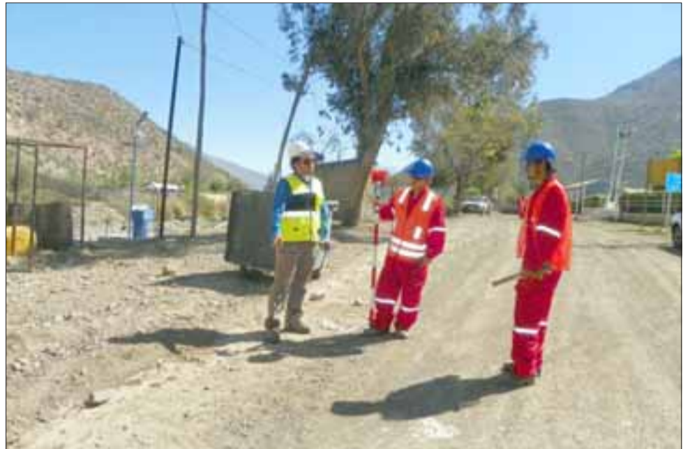
El Ministerio de Obras Públicas informó que dio inicio a la pavimentación de tres tramos de la ruta E-525, sector Los Patos en la comuna de Putaendo.
