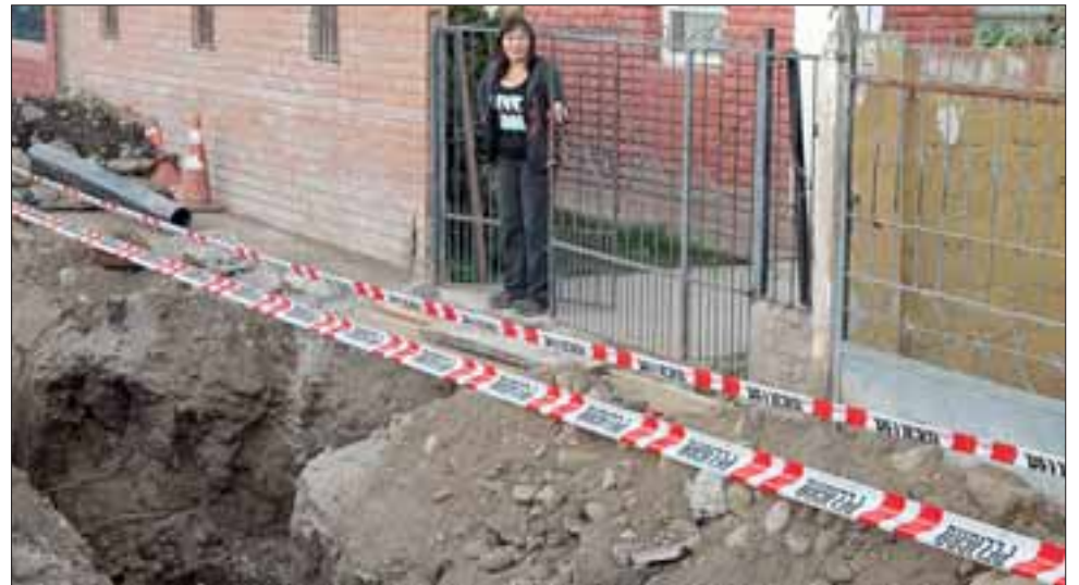
Los vecinos denunciaron que conversaron con trabajadores de la empresa a quienes les reclamaron el pésimo estado de las pasarelas que instalaron.
