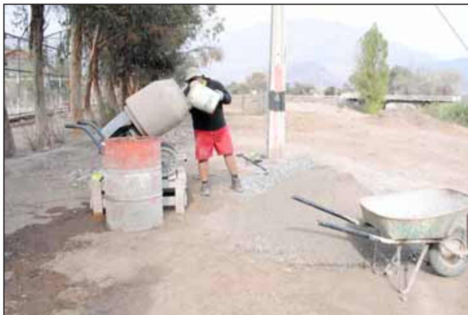
El municipio ya comenzó la construcción de cierre perimetral de un sector de Villa Las Acacias III.
