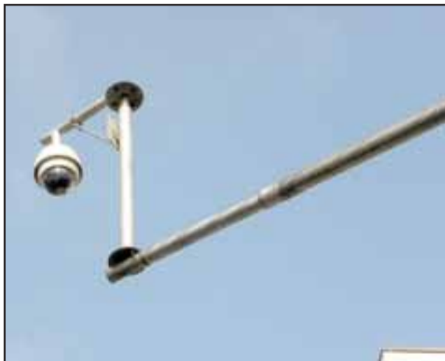
OJO LIMITADO.- Si bien las cámaras de tele-vigilancia están funcionando, los obstáculos visuales de la ciudad no permiten que éstas funcionen correctamente en la prevención del delito, en algunos sectores de la ciudad.
