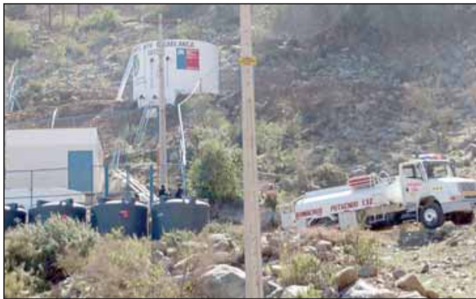
Una falla técnica en el sistema de válvulas de la planta del Comité de agua potable rural de Casa Blanca, sería la causa de que hoy más de 1.500 vecinos de ese sector lleven varios días sin el vital elemento.
