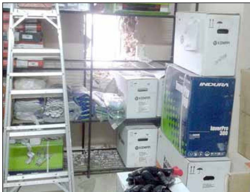
Por este forado los delincuentes ingresaron para cometer el robo al Local Indura para sustraer millonarias máquinas soldadoras, dado que el establecimiento no contaba con dinero en efectivo.
