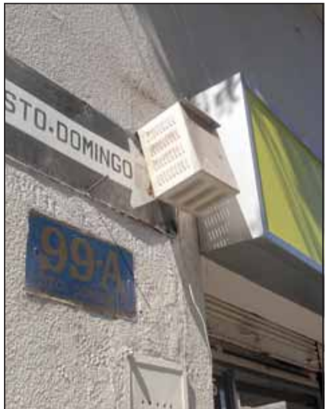
Los antisociales cortaron los cables para destruir el sistema de alarma para intentar ingresar a robar a las oficinas cuya acción se vio impedida tras la llegada de Carabineros de San Felipe.
