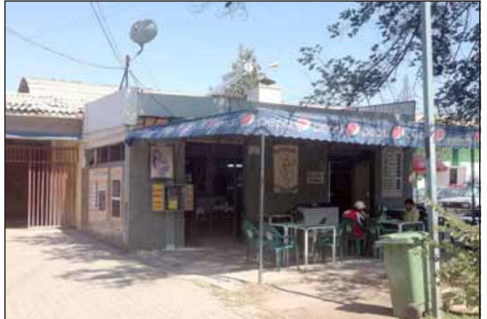
Restaurante El buen comer ubicado al interior del terminal rodoviario de San Felipe, delincuentes ingresaron por medio de un forado en el techo para llevarse consigo un televisor LCD y mercaderías que superan un monto en más de un millón de pesos.
