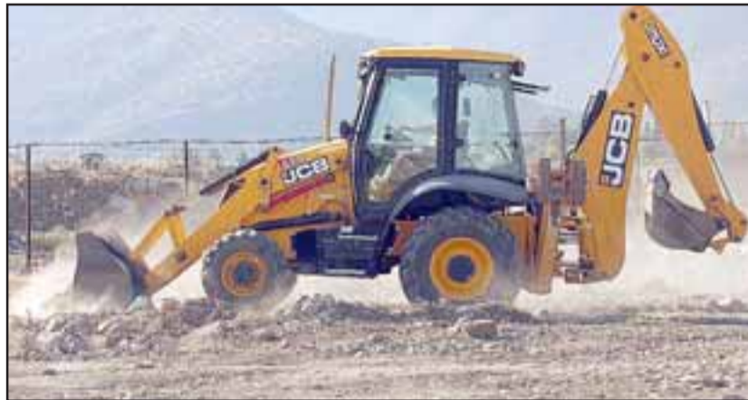
En forma oficial comenzaron los trabajos de construcción del nuevo y moderno Complejo deportivo Newén de Putaendo.
