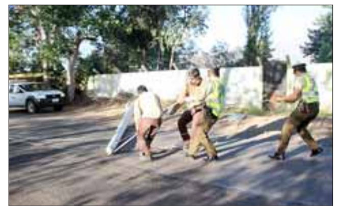
Funcionarios de Carabineros junto a personal de Chilquinta debieron retirar el poste de la calzada.
