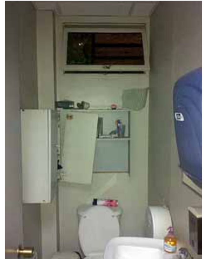
Por esta pequeña ventana del baño, ingresó el sujeto que intentó robar en el Banco Credichile.
