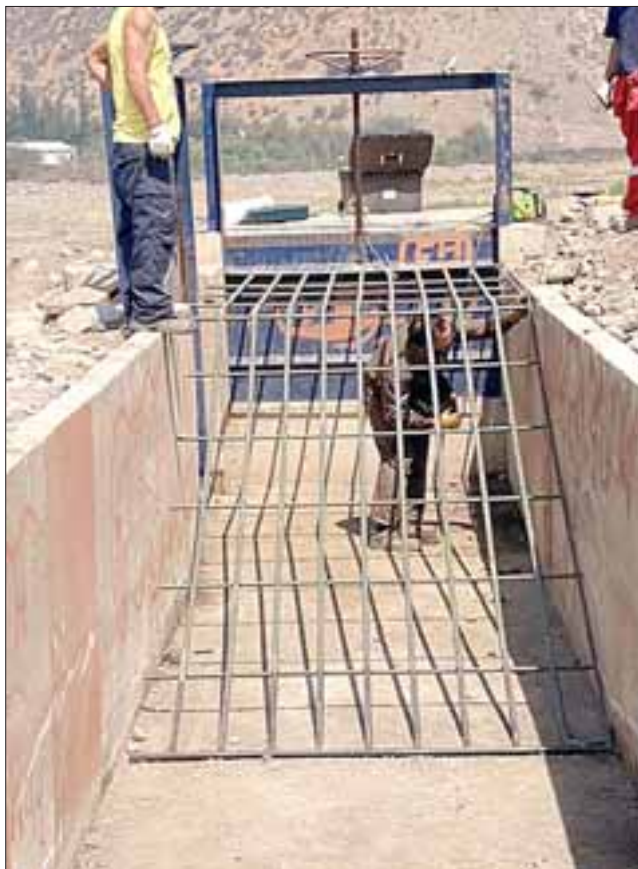
Esta es la obra que realizó la empresa Atacagua, que causa risa entre quienes no viven en el sector, pero indignación en aquellos que sí viven en el lugar.
