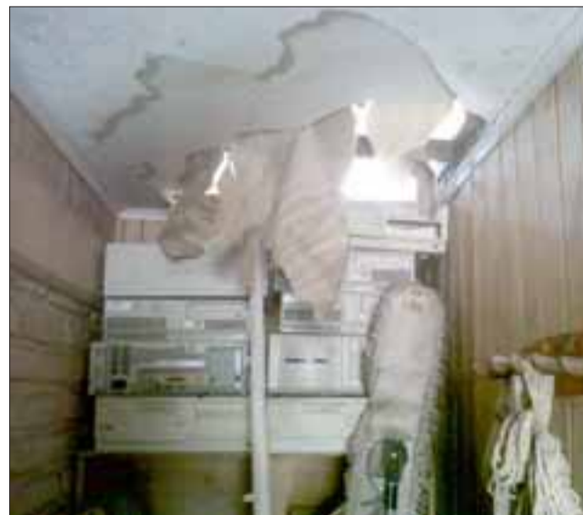
Un enorme forado en el techo, realizaron los delincuentes que ingresaron para cometer el último robo en la Escuela Manuel Rodríguez.
