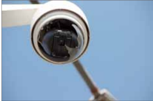
DESTRUIDA.- Destruída y sin poder ser de más utilidad, así quedó esta cámara de vigilancia en el centro de Putaendo.
