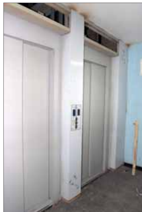
Obras menores correspondientes a salidas del ascensor, colocación de placas y pintura, son lo único que restan para concluir este proyecto.
