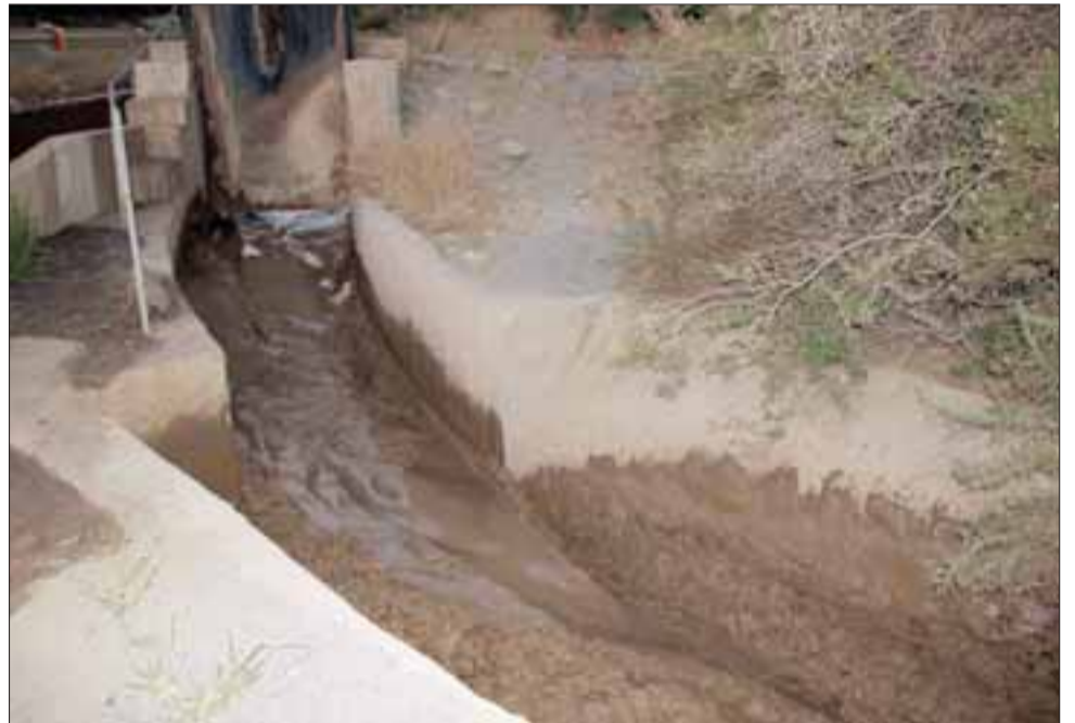
El exceso de sedimento y arena que arrastran las aguas del Río Putaendo, está originando serios inconvenientes en los distintos canales de regadío de la comuna.
