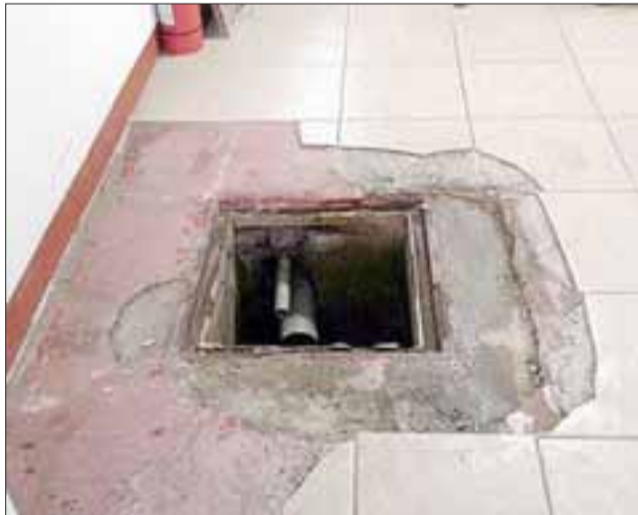
Alarma causó la explosión de la cámara de una alcantarilla al interior de un restaurante del centro de Los Andes.
