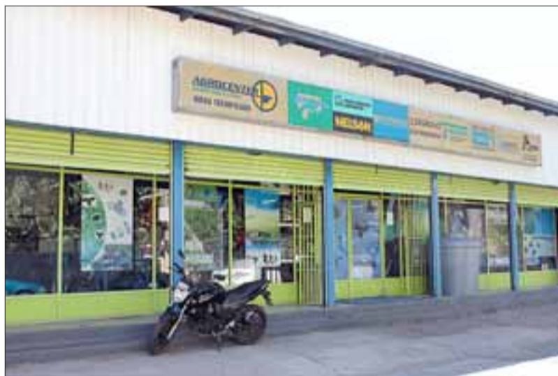
Los delincuentes efectuaron un forado en el techo, que tiene doble zinc, para ingresar a las dependencias y perpetrar el robo.
