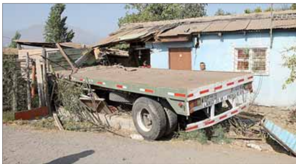
Los daños en el inmueble fueron importantes e incluso una habitación que era ocupada como comedor quedó totalmente destruida.
