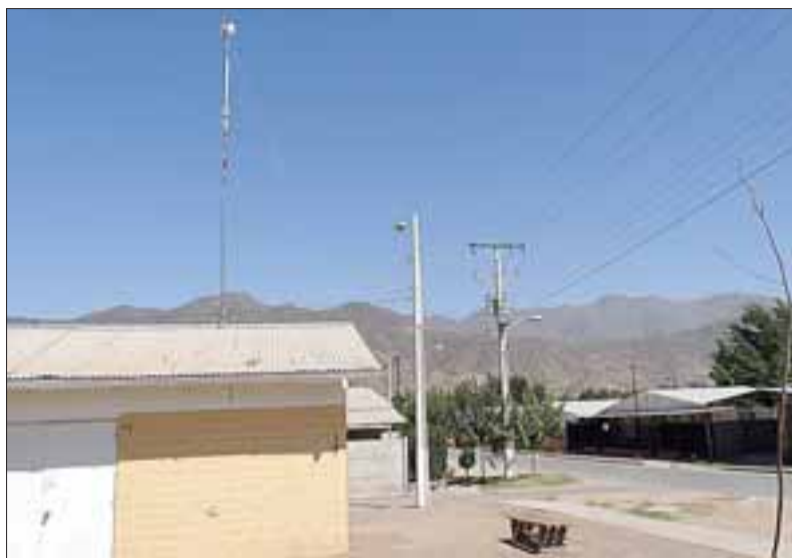
Un 98% de avance presenta la instalación de las antenas para la implementación Wi Fi gratuita para toda la comuna de Rinconada.
