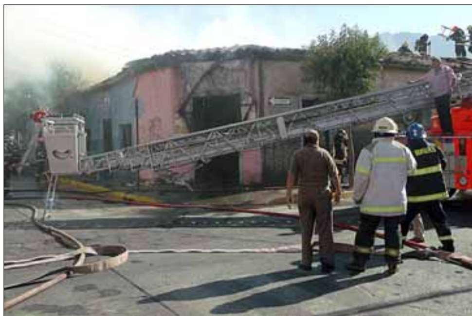
Al parecer, la existencia de gran cantidad de elementos altamente combustibles al interior de la zapatería, favoreció la acción del fuego.
