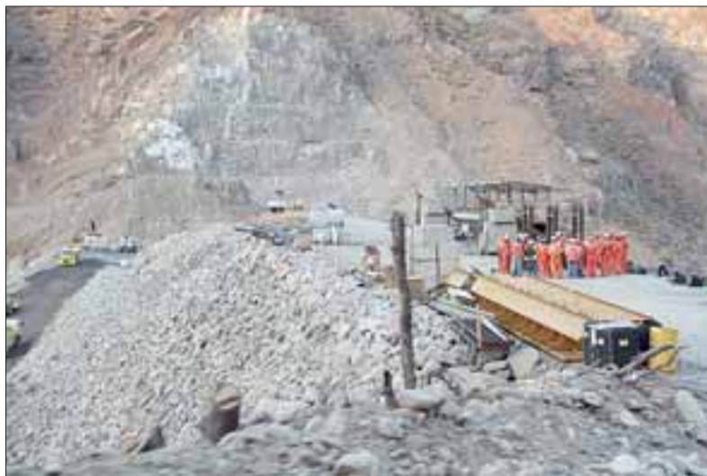
Un grave accidente se registró al interior de las obras de construcción del Embalse Chacrillas luego que el conductor de un camión debiera saltar desde el vehículo en movimiento para salvar su vida.
