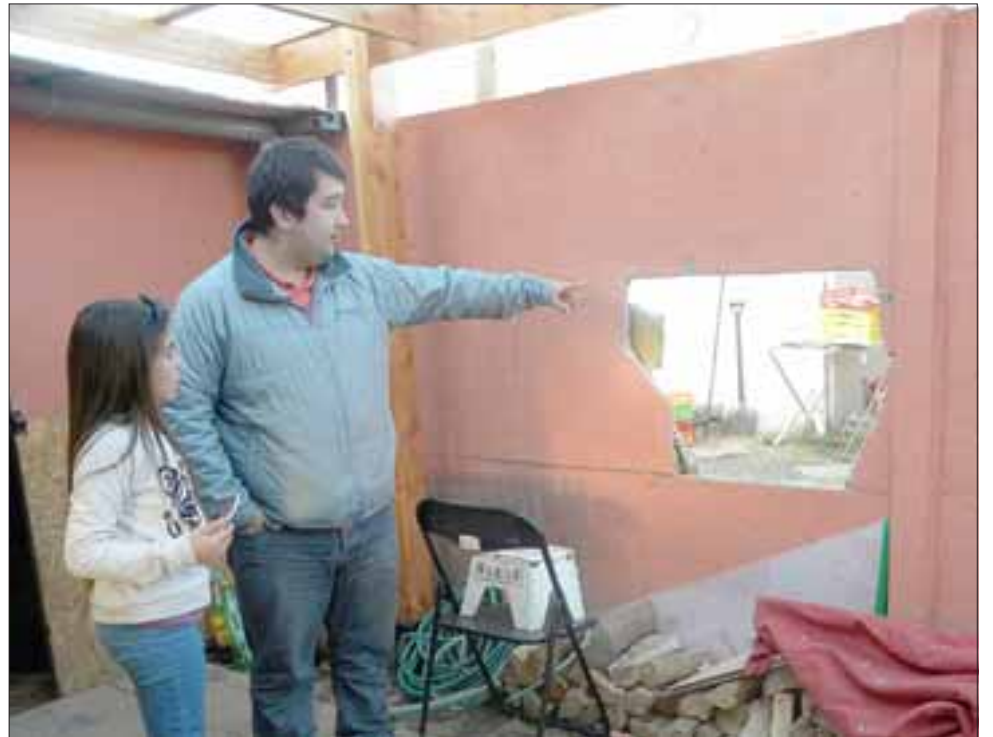
Christofer Muñoz enseña el lugar por donde los delincuentes pasaron de una vivienda a otra, llevándose especies y causando daños en ambos inmuebles.
