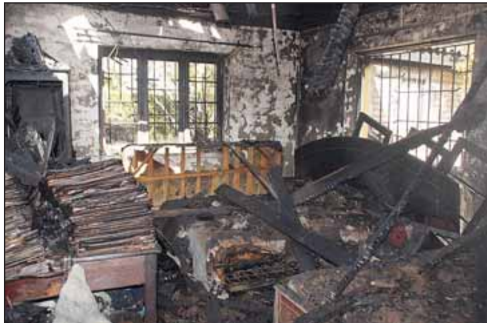
PÉRDIDAS TOTALES.- Las pérdidas son totales y señaló que será el Departamento Técnico de Bomberos el que deberá determinar las causas eventuales del incendio.
