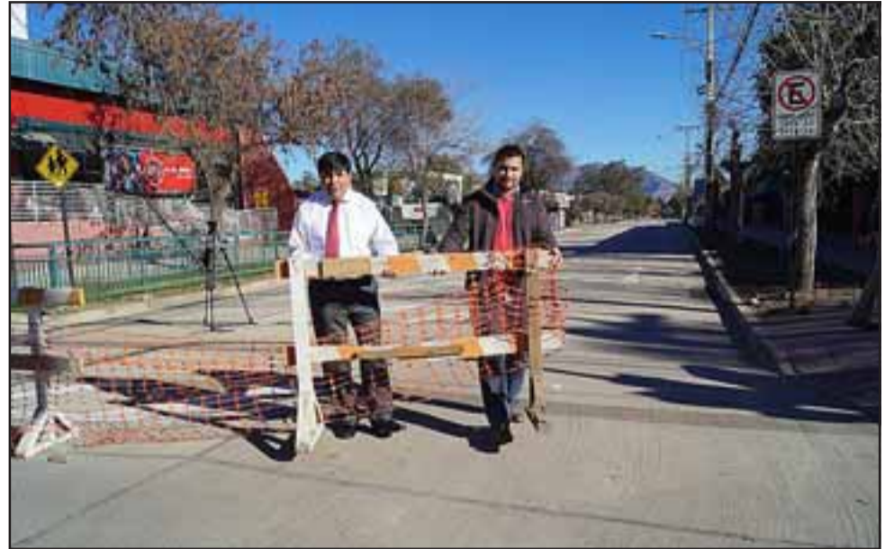
A contar de este viernes quedó abierta para la circulación de vehículos Avenida Chacabuco en toda su extensión, luego que se dieran por finalizadas las obras de la segunda etapa.
