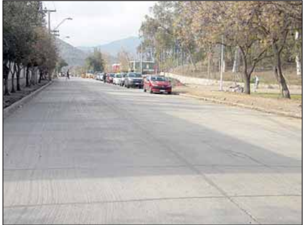
Para la primera quincena del mes de julio estarían siendo entregadas las obras de repavimentación de Avenida Chacabuco.
