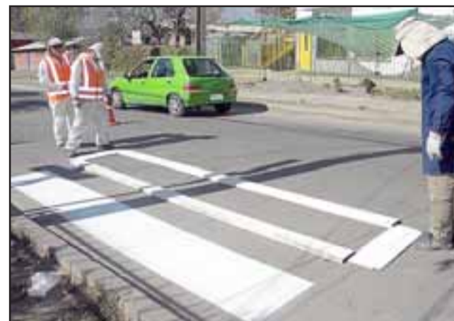
Se reinstaló el lomo-toro en Avenida Independencia frente a la Escuela España, el cual había sido sacado producto de los trabajos de repavimentación de esa arteria.
