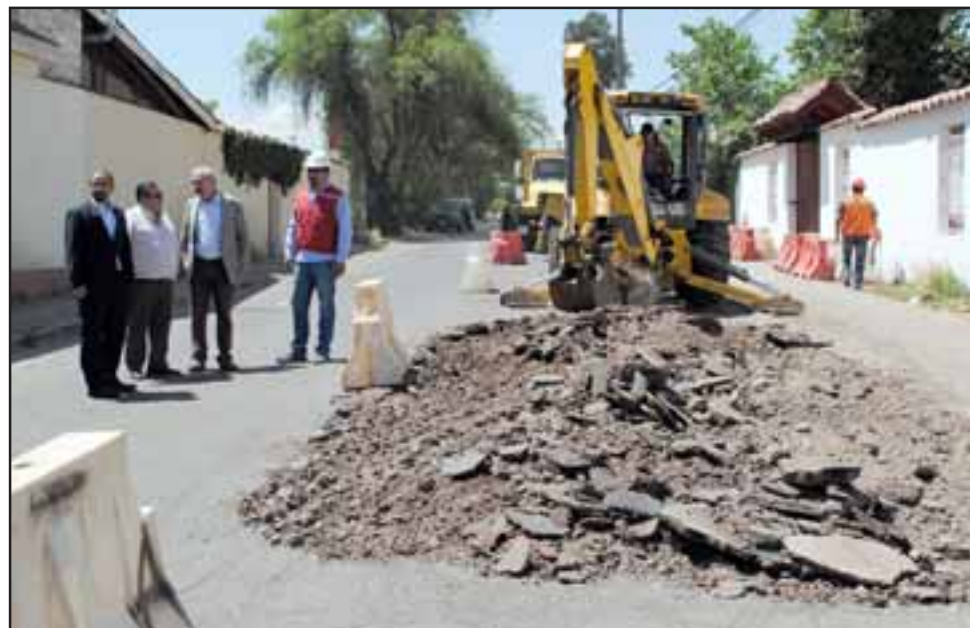
Este jueves, luego de años de espera de los vecinos del sector Almendral, comenzaron los trabajos de pavimentación de Calle Belisario Montenegro, una obra que contempla una inversión cercana a los $800 millones.
