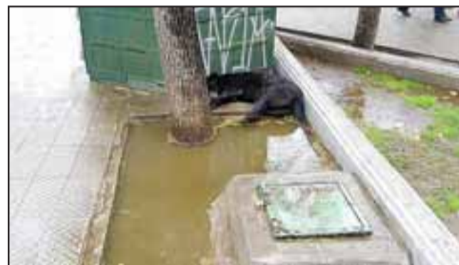
Lo grave de esta situación es que un niño podría sufrir una descarga eléctrica si se acerca a esta caja.
