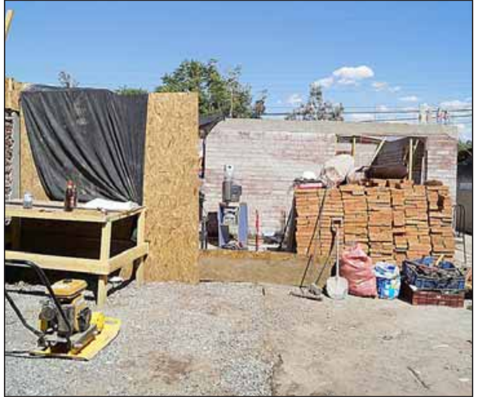
A estas familias la empresa Chilquinta les exigiera un cobro para reponer el empalme de luz a sus domicilios, mismo que actualmente se encuentran en fase de reconstrucción.
