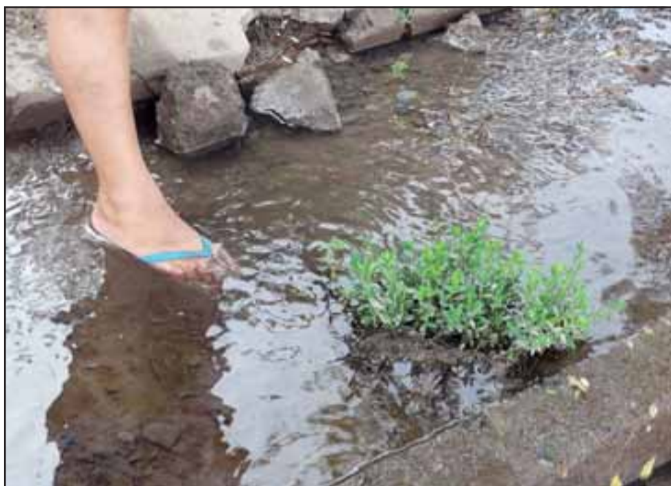
Aunque la cantidad de agua que se pierde quizás no es significativa, el filtrado constante ha debilitado la base del pavimento que ha ido rompiéndose.
