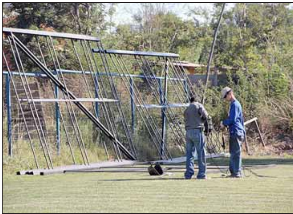
El Club deportivo Inter Sporting exigió que la empresa que se encuentra construyendo una sala múltiple en sus dependencias, no siga dañando el césped del campo deportivo.
