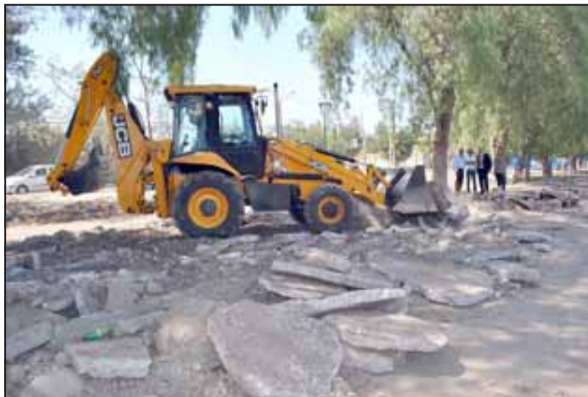
El Alcalde Freire recorrió el lugar, constatando los trabajos que contempla la siembra de césped, riego tecnificado e instalación de solerillas.
