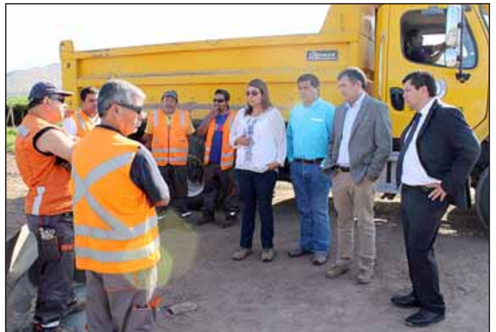
Ayer miércoles las autoridades se hicieron presentes en el sector de Calle San José de Santa María, para fiscalizar el inicio de los trabajos asfálticos que se desarrollarán en 5,1 kilómetros de la comuna.
