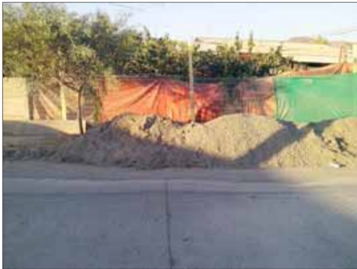
En Población Ambrosio O'Higgins Esval, se encuentra realizando mejoras de alcantarillados, sin embargo, no lo habrían hecho con prolijidad.
