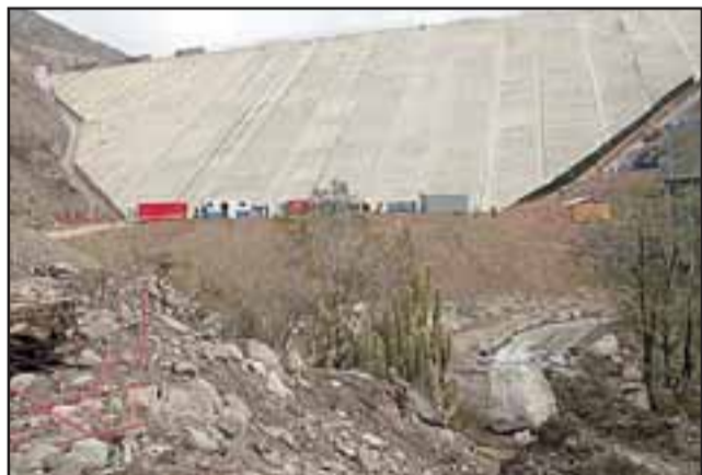
La obra del Embalse Chacrillas fue testigo de un grave accidente este miércoles.
