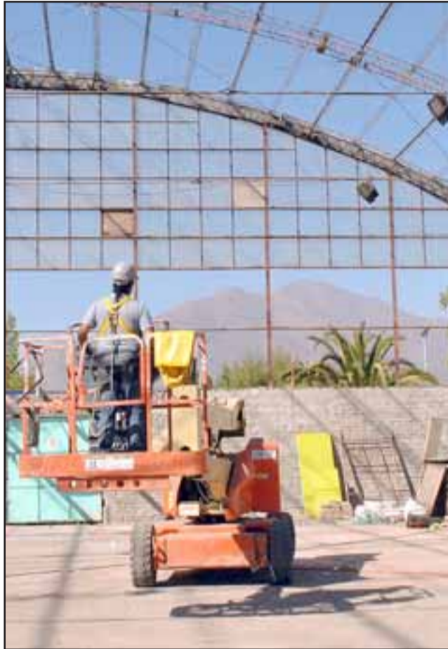
El proyecto contempla el mejoramiento integral del gimnasio de este emblemático liceo y significará el cambio completo de la techumbre.
