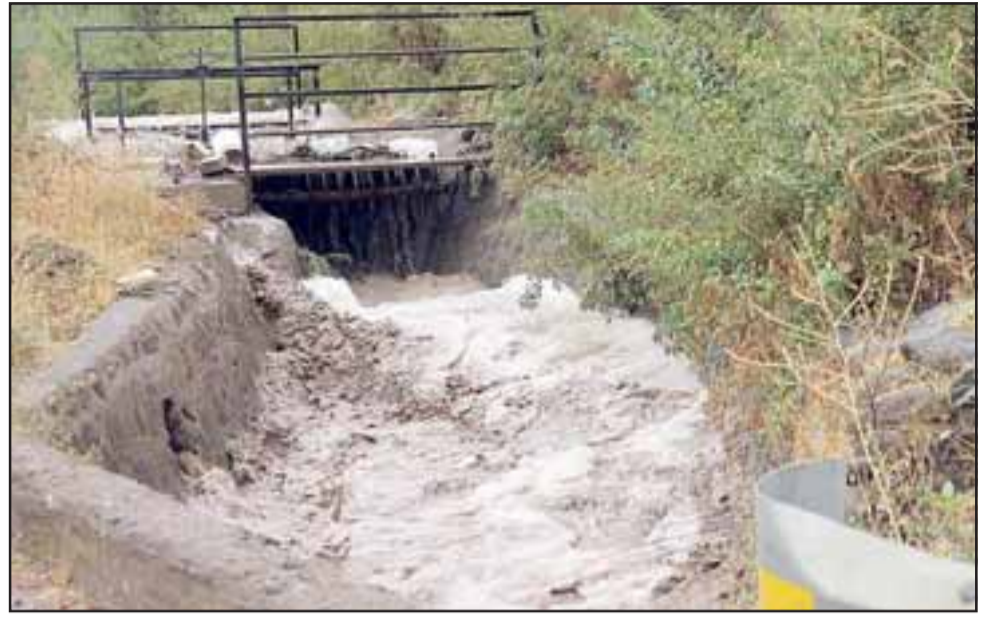
Las lluvias que afectaron a Putaendo superaron los 15 milímetros, lo que provocó el aumento del caudal del Río Putaendo.
