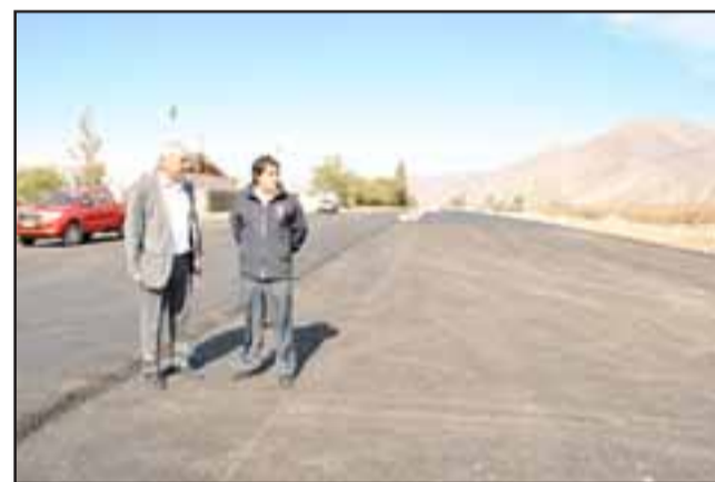
El Alcalde Patricio Freire y el Secretario Comunal de Planificación, Claudio Paredes, visitando a las obras de pavimentación de la Avenida Chercán Tapia.
