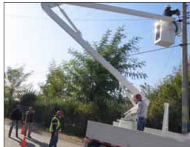
El camión hidroelevador, además de realizar el mantenimiento a las luminarias públicas, también podrá prestar ayuda a Bomberos en emergencias en alturas.
