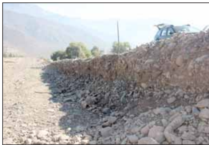
Las intensas lluvias podrían provocar estragos en las poblaciones aledañas al Estero Seco debido a la acumulación de agua en este muro.
