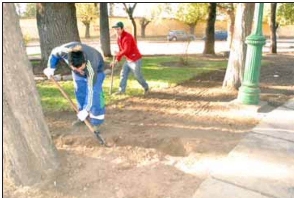
El proyecto considera el recambio del pavimento, de escaños y el mejoramiento de las áreas verdes del sector mediante la instalación de un sistema de riego tecnificado.
