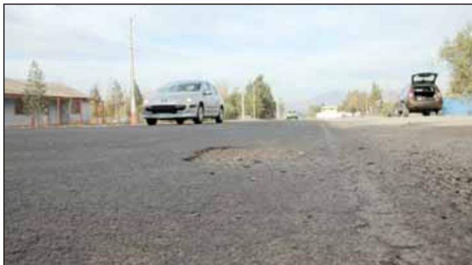
En Av. Alejandrina Carvajal existe un peligroso hoyo que genera gran malestar en la población ya que daña los autos que transitan por el lugar.
