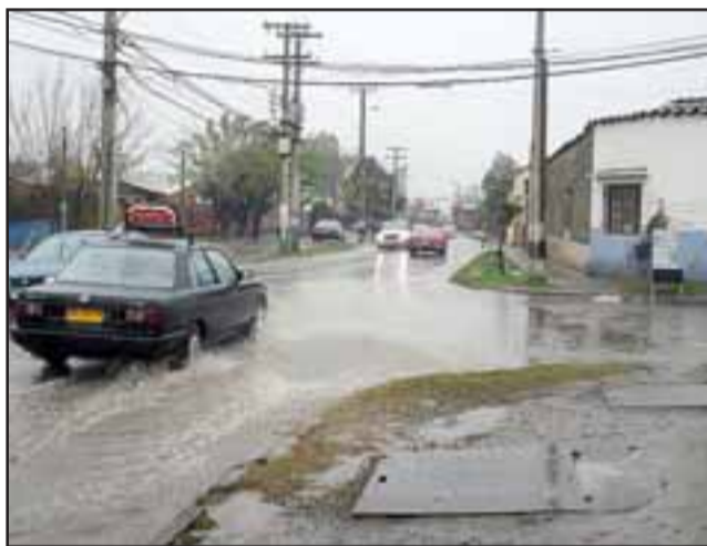
Debido a las obras que se realizan en calle Arturo Prat, vecinos piden a los responsables de estos trabajos que procuren un plan de mitigación para evitar que el agua y el barro no ingrese a sus casas.
