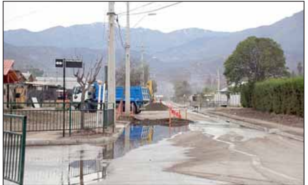
Dos semanas lleva una rotura de matriz sin ser reparada en la Población San Antonio lo que ha generado gran pérdida de agua.
