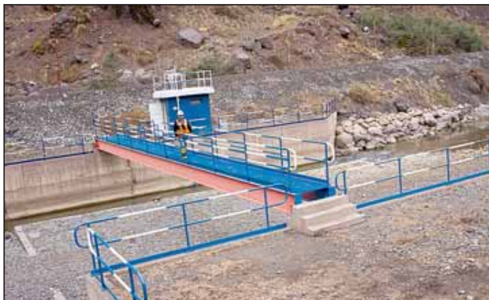
En el kilómetro 14 del camino hacia el área industrial de la División Andina, se ubica una de las estaciones que monitorea, minuto a minuto, la calidad de las aguas del río Blanco, y que están disponibles en la página http://dgasatel.mop.cl .
