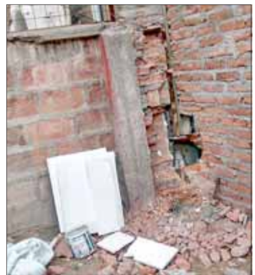
Por este forado en un muro los delincuentes ingresaron hasta las dependencias de la Cooperativa.
