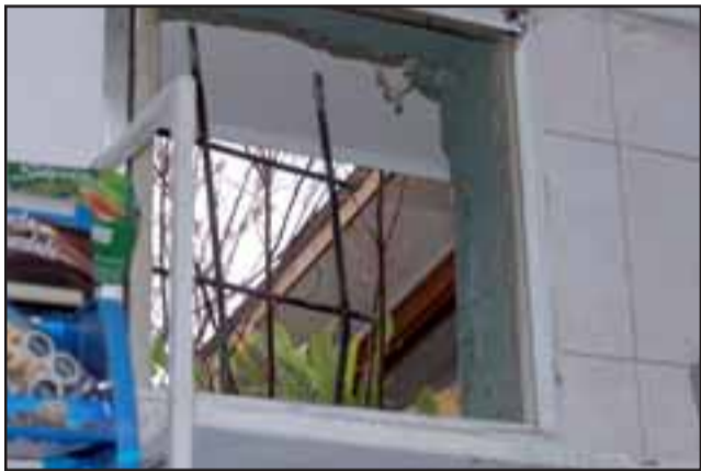
DÉBIL SEGURIDAD.- Por esta pequeña ventana ingresaron los delincuentes, pareciera que también los comerciantes no refuerzan sus medidas de seguridad.
