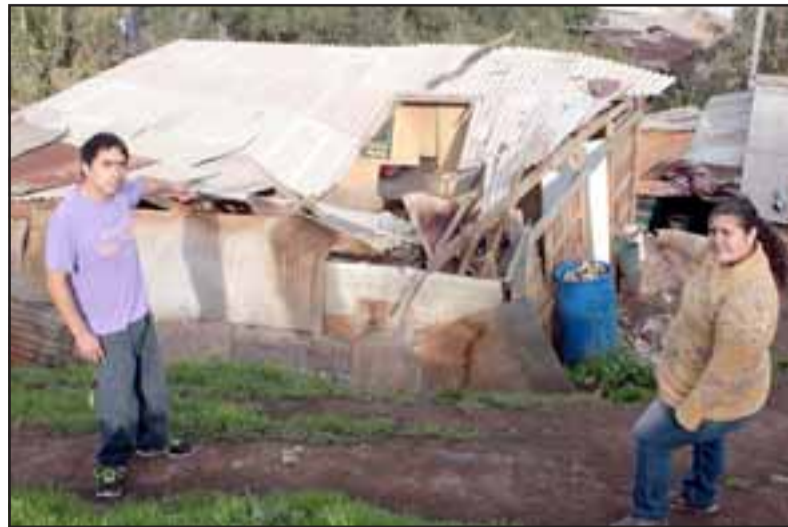
CASA DESTRUÍDA. - Terecita (con c) Hidalgo y Marcelo Cisternas, vecinos de Camino La Copa, muestran a Diario El Trabajo los daños en esta humilde vivienda causados por la pesada llanta en su rodamiento.
