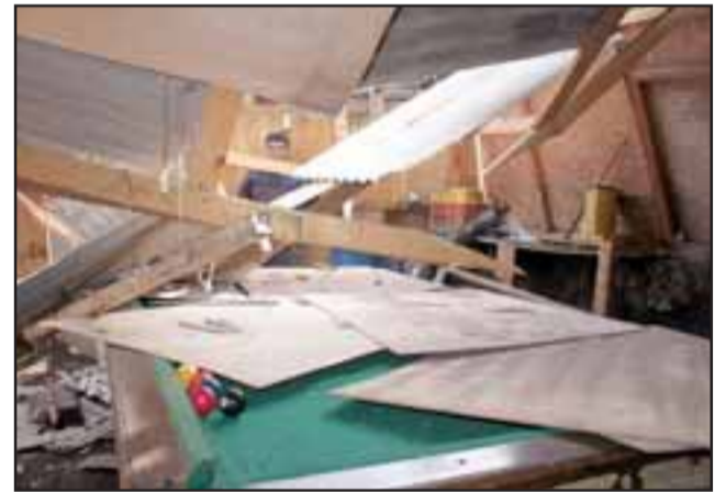
Este vecino muestra a nuestras cámaras los daños al interior de esta vivienda.
