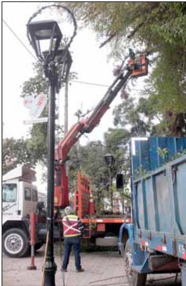
RAMAS TAMBIÉN. - También las ramas que están quebradas y que podrían caer sobre las personas, fueron cortadas de sus árboles.
