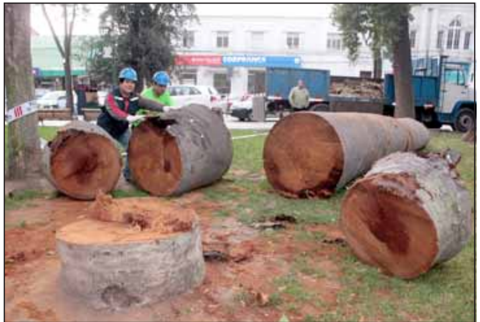
ADIÓS PALMERA. - Ayer martes los obreros de la empresa Em Huella Ltda. Se dieron a la tarea de talar una palmera y un roble americano que estaban en la Plaza de Armas ya en peligro de caer. Así, son más de 40 las intervenciones en este sentido que el Municipio ha ordenado desarrollar en nuestra ciudad. (Foto Roberto González Short)
