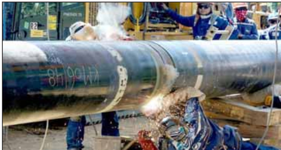
La División Andina de Codelco confirmó la rotura de un ducto de concentrado de cobre al interior del área industrial, el cual según la empresa no generó daño ambiental.
