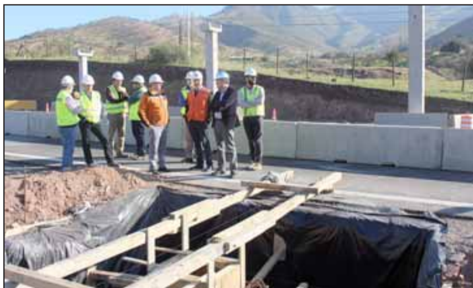
Hasta el sector de los trabajos, llegaron el secretario regional ministerial de Obras Públicas, Miguel Saavedra y el gobernador de la Provincia de San Felipe, Eduardo León, quienes se interiorizaron del avance del proyecto que ejecuta la empresa concesionaria en la vía.
